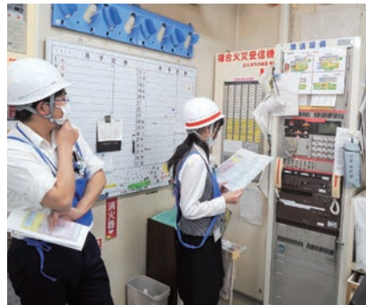
避難放送・消防署からの逆信対応
